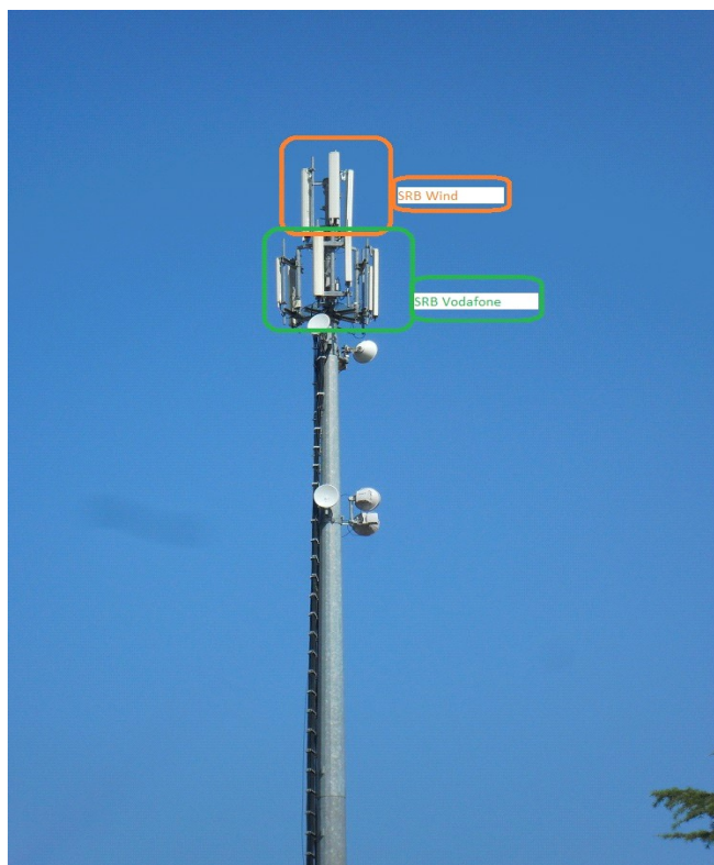
Impianti SRB WIND e VODAFONE di Via Corbellini
